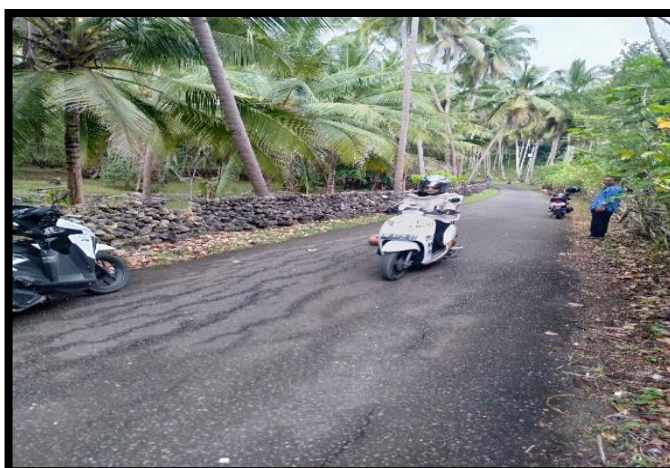
Gambar 2.1 Kondisi jalan di Kecamatan Bontosikuyu
